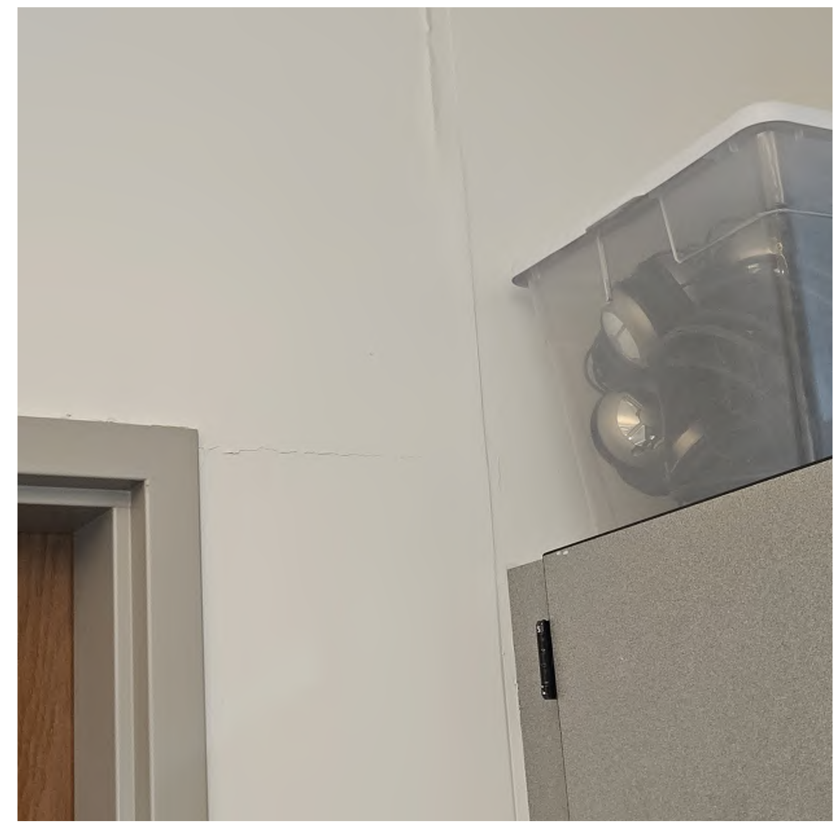
6 CRACKED DRYWALL ABOVE DOOR G120
